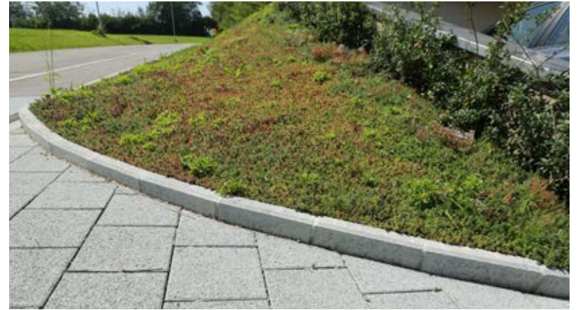
bordures/bordurettes mécanique en tant que finition
